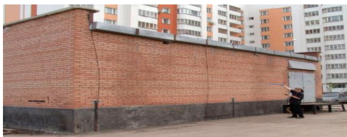
Рисунок 3.4 - Внешний вид исследуемой трансформаторной подстанции
