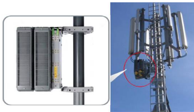
Рисунок 4.2 - Базовая станция сети LTE
