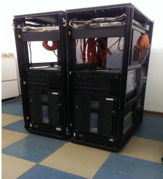
Рисунок 2.2 – Серверное оборудование IBM BladeCenter
