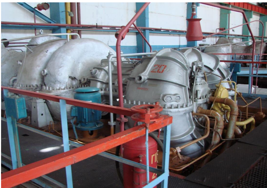
Рисунок 5 – Газовая турбина мощностью 10 МВт.
