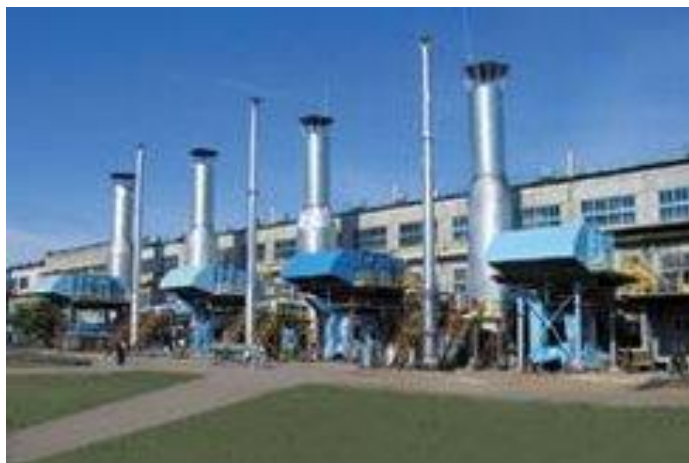
Рисунок 2.3 – Установка ГТК-10-4 на КС
