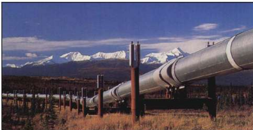
Рисунок 1.3 – Надземный магистральный трубопровод
