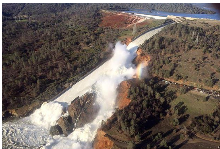
Рисунок 7 – Разрушение водосброса плотины
