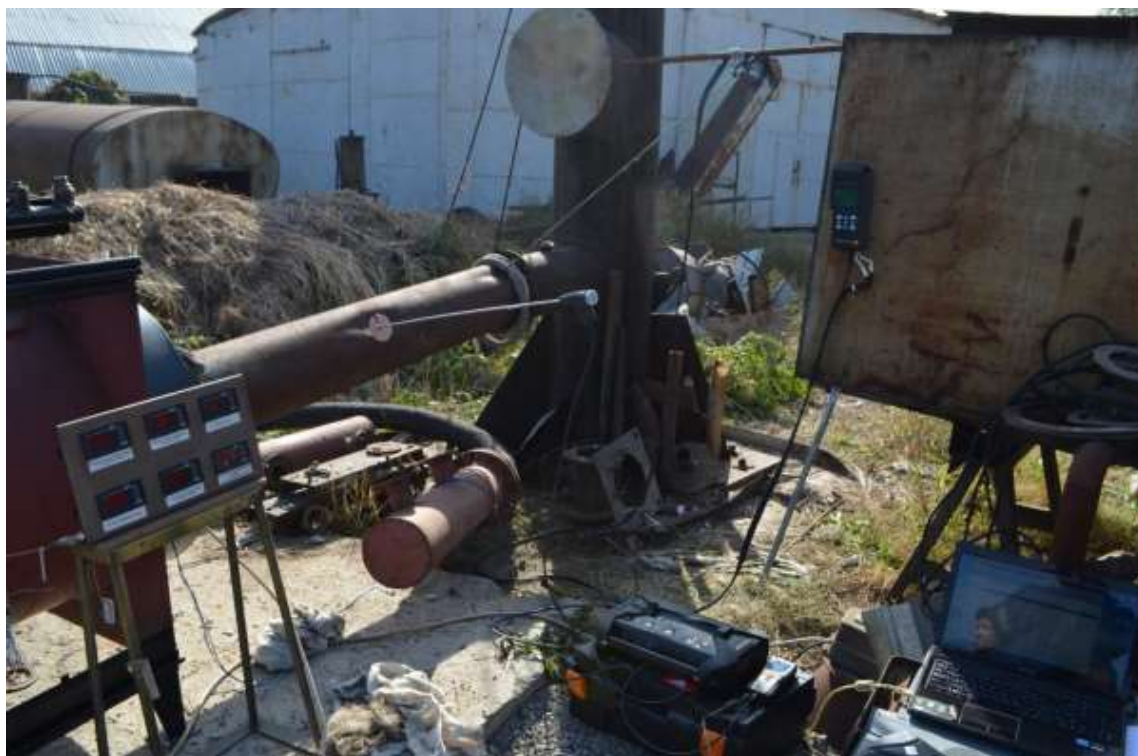
Рис. 3. Общий вид установленных измерительных приборов (газоанализатор с управлением замеров состава уходящих газов в режиме реального времени через ноутбук (зонд в газоходе ближе к котлу), управляющий модуль непрерывного измерения температуры уходящих газов (зонд в газоходе ближе к дымовой трубе), (авторский снимок, 26.10.2018г.)
