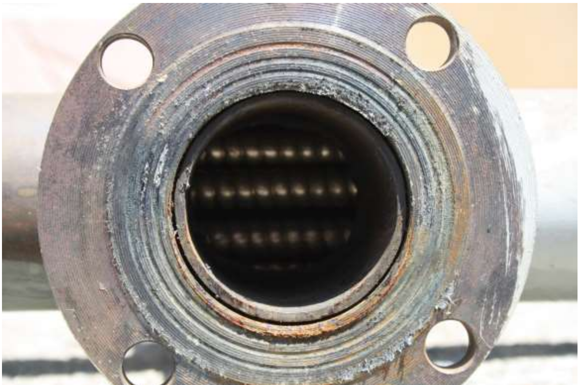
Рисунок 3.6 – Вид витых труб внутри теплообменного аппарата
