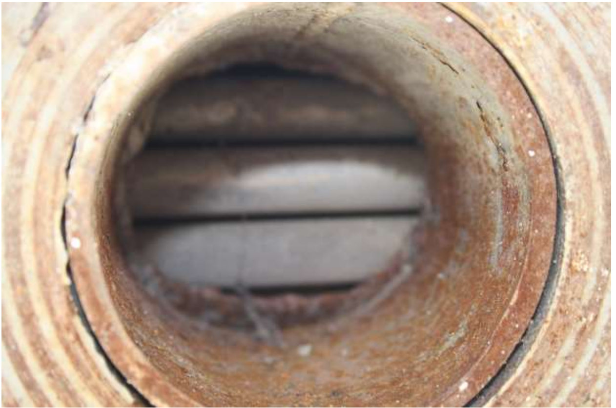
Рисунок 3.5 – Вид гладких труб внутри теплообменного аппарата
